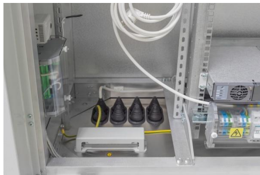
Rysunek 6. Przepusty w podłodze szafy
